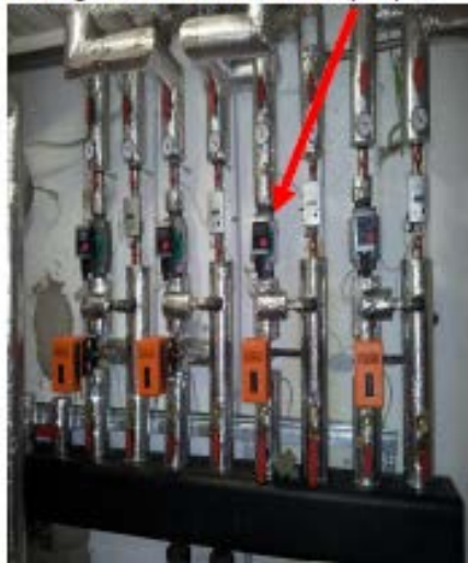
Heizungsverteiler mit Hocheffizienzpumpen
