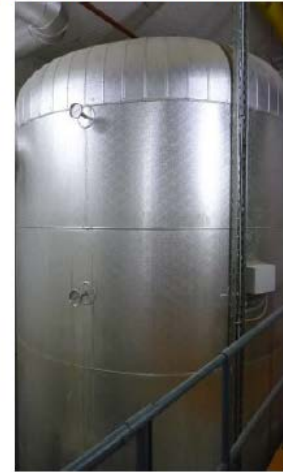
Wärmespeicher der Heizzentrale 23 m³
