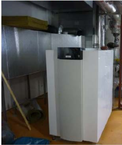
Brennwertkessel thermisch 539kW
