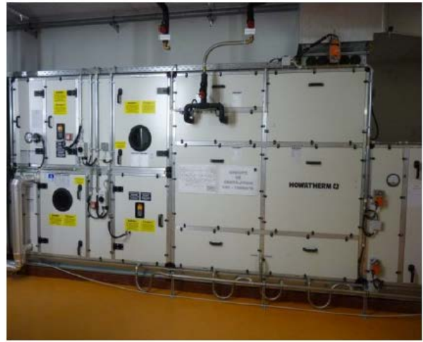
Lüftungsanlage 7.250 m 3 / Stunde
